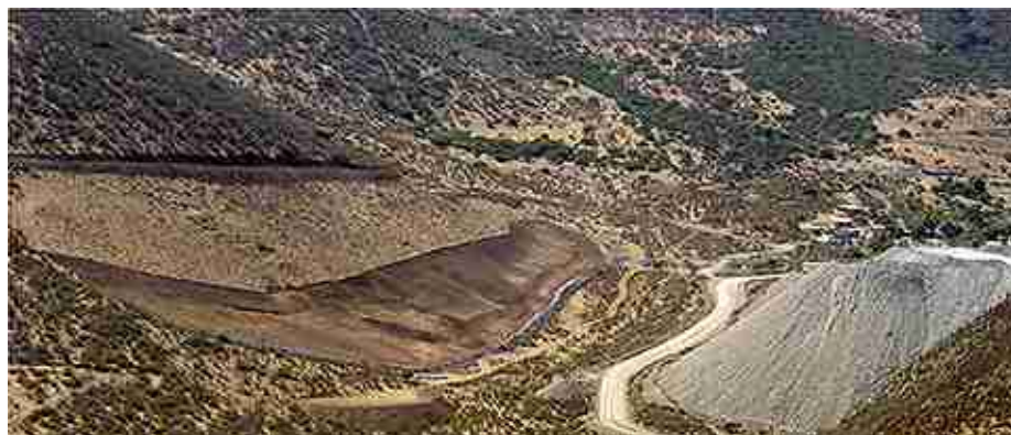
Etapa de construcción, marzo 2006: Duración estimada 3 meses. Duración real 3 meses. Actividades Ejecutadas: corta de vegetación, escarpe y remoción de capa superficial, pretil, canal perimetral, sistema drenaje, cámara de inspección, camino.
