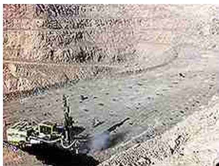
Perforadora Furukawa finalizando malla de producción.
