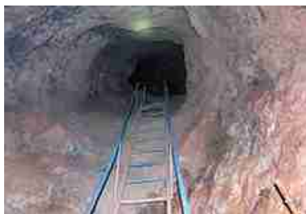
Salida de emergencia.
