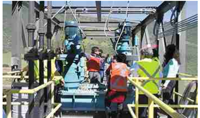
En Espesador de Cono Profundo.
