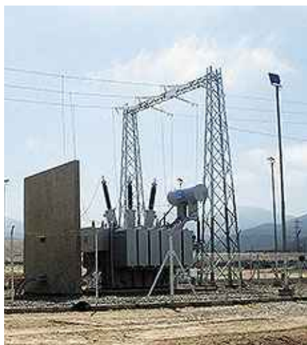
Central Eléctrica, Copiapó.
