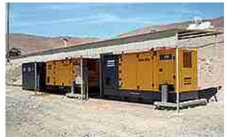
Grupos generadores GAS 250 y compresor GA 110.
