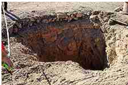
Primer día de Mina Tropezón. El pique de extracción se recibió en estas condiciones.
