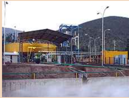
Vista general bomba (pistón), piscina e instalaciones eléctricas.
